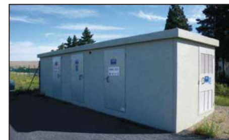
Photographie 102 : Exemple de poste de livraison "brut".
