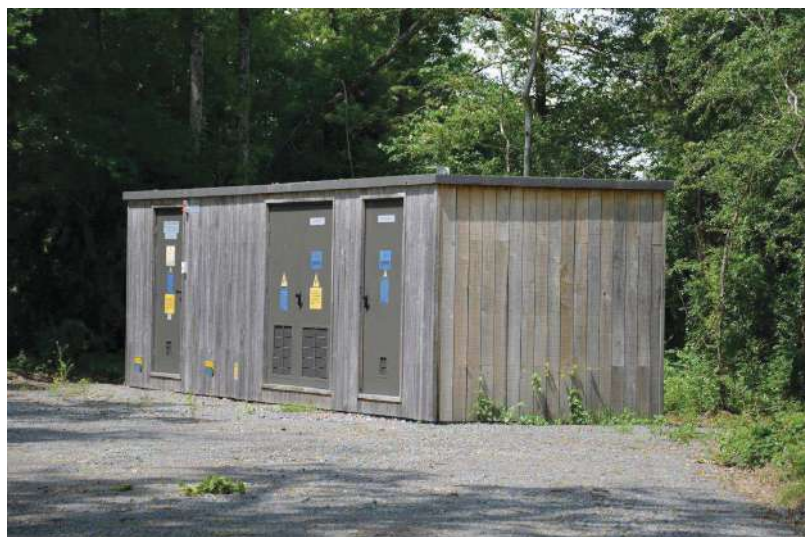
Photographie 86 : Exemple de poste de livraison avec un bardage bois.
